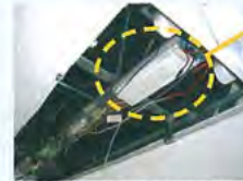
④安定器を下記の方法に従って切断、配線変更を行って下さい。
